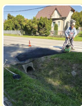
Vyvýšenie asfaltu na križovatke Školskej ulice
